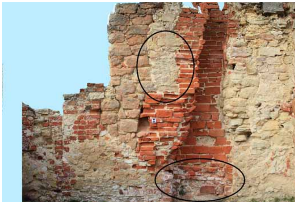
Fot. 4. Ortofotomapa ściany N pomieszczenia 5 (wg lustracji z 1644 r.) z zaznaczonymi wykwi-tami soli (dolne zakreślenie) oraz słabo rozpoznawalnymi fragmentami muru (górne zakreślenie). Stan na 2013 r. (wyk. M. Kowalczyk, oprac. J. Markiewicz – Politechnika Warszawska).
